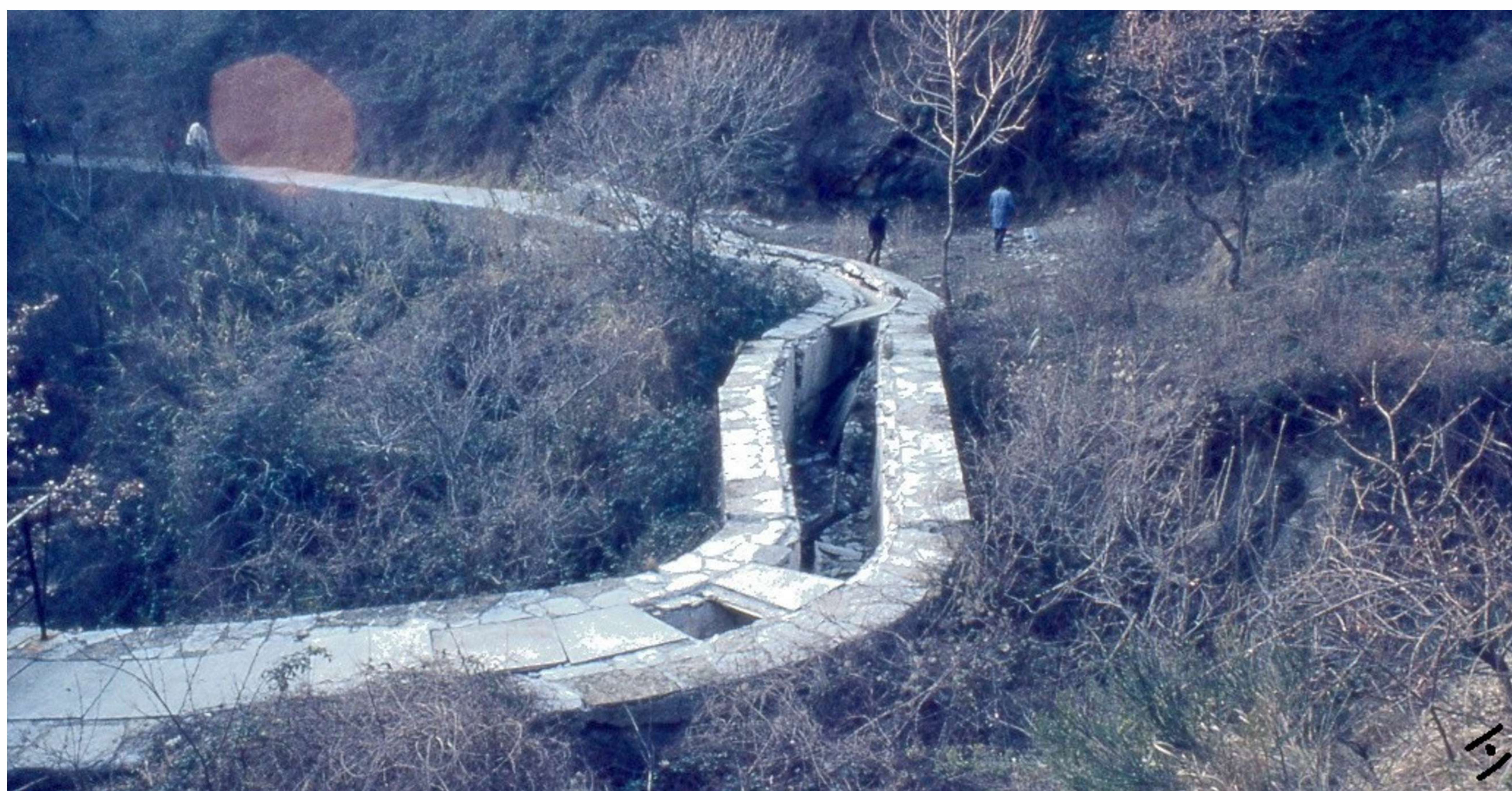
1981: l'agonia della struttura a cui ha fatto seguito il crollo.
